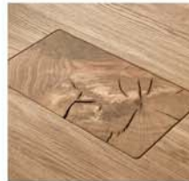
Hirnholzeinlage mit offenen Rissen
